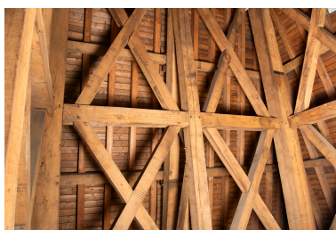
Détail de la charpente avec la seconde partie de l'inscription. Phot. Marc Kérignard IVR32_20258001133NUCA
