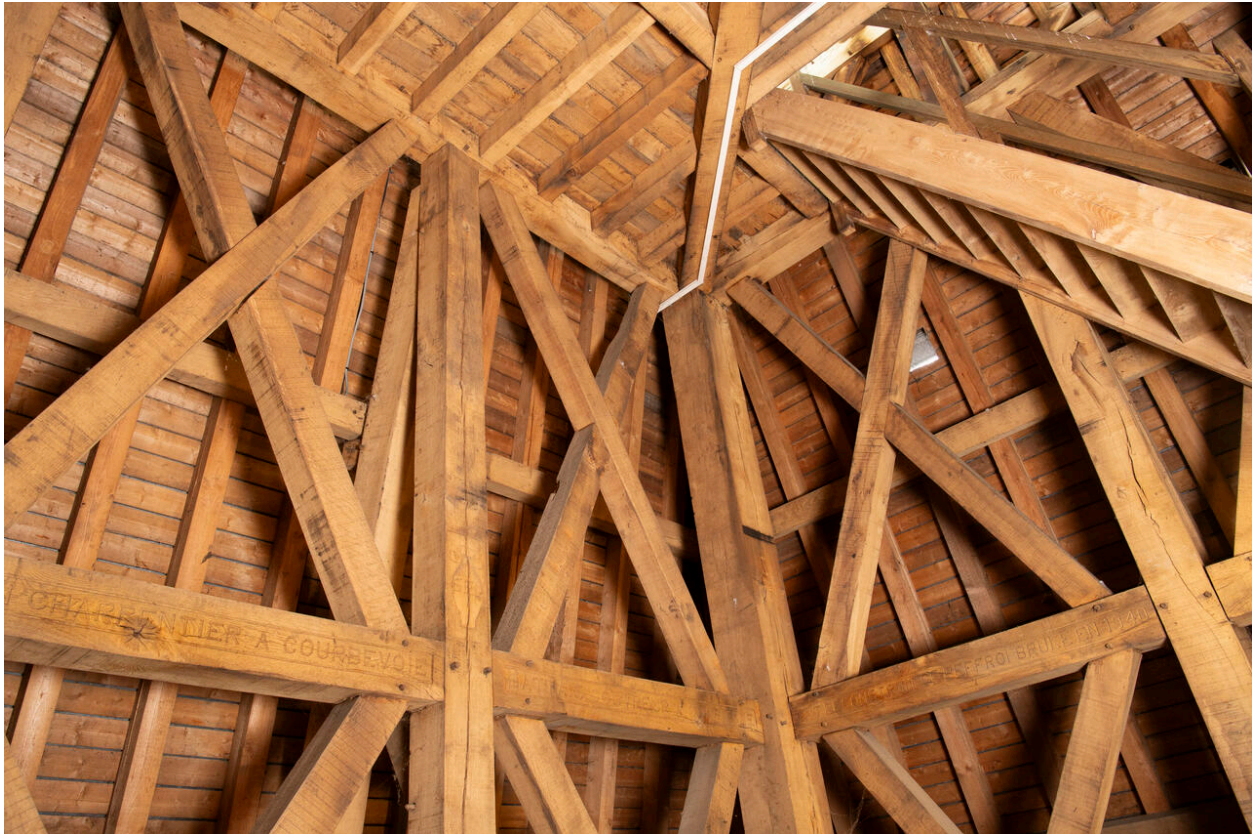
Vue générale de la charpente avec l'échelle de meunier permettant d'accéder à l'étage supérieur.
