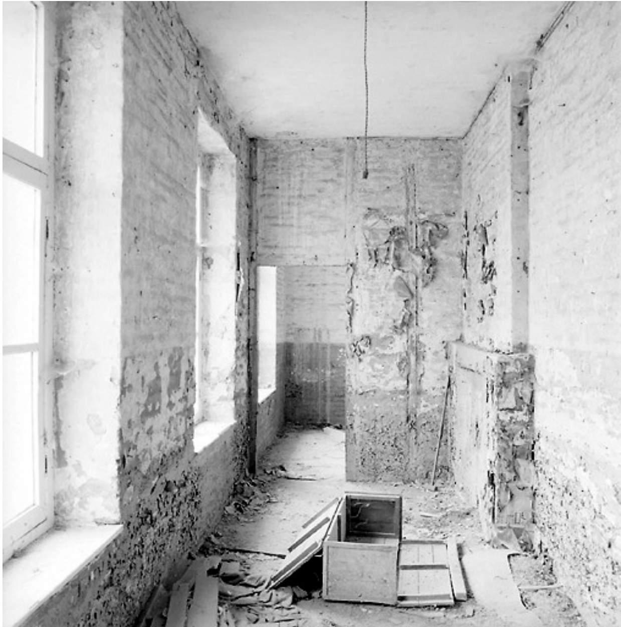
Corps de garde, intérieur, second étage à usage de logement : salle sud-ouest, état en 2005.
