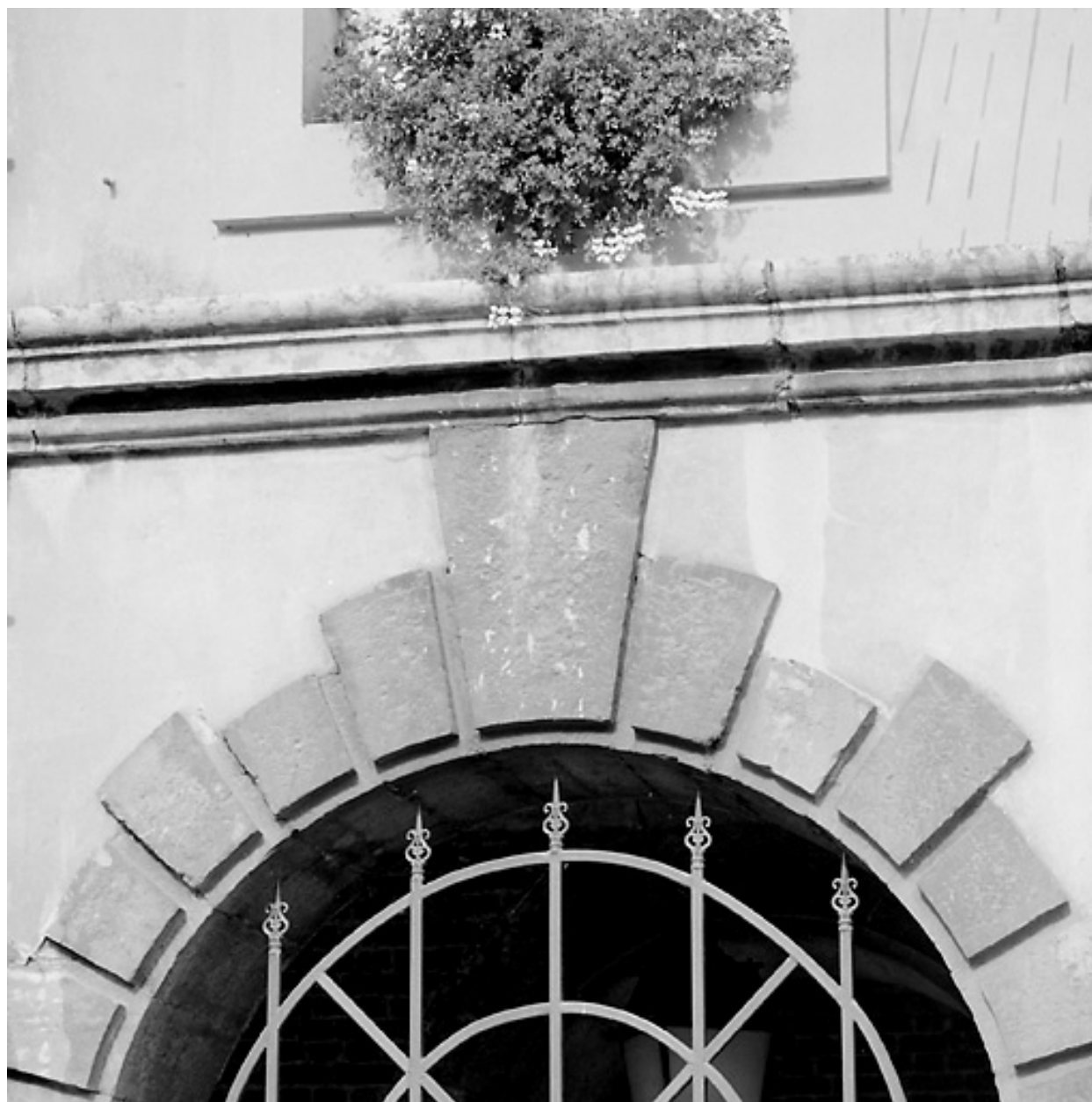
Corps de garde, façade, rez-de-chaussée : encadrement des baies en bossage à table plate.
