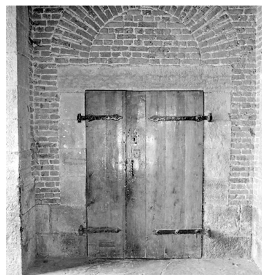
Corps de garde, intérieur, rez-de-chaussée : porte d'accès à l'ancienne salle de repos des gardes. Phot. Pierre Thibaut IVR31_20055900785X
