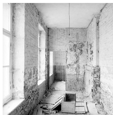
Corps de garde, intérieur, second étage à usage de logement : salle sud-ouest, état en 2005. Phot. Pierre Thibaut IVR31_20055900787X
