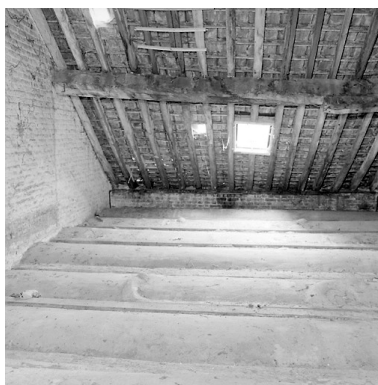
Corps de garde, intérieur, premier étage : extrados du couvrement de l'ancienne salle de repos des gardes. Phot. Pierre Thibaut IVR31_20055900786X
