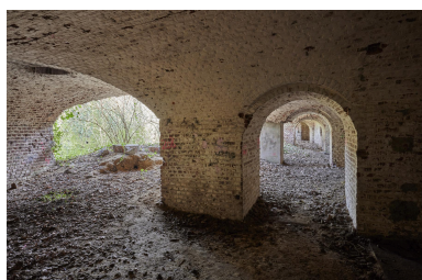
Aile est. Embrasures de tir dans le mur de masque, en partie effondré. Phot. Pierre Thibaut IVR32_20235900132NUCA
