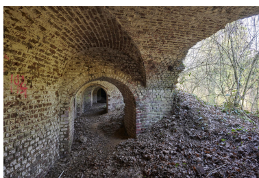
Aile est. Partie effondrée des galeries flanquantes. Phot. Pierre Thibaut IVR32_20235900129NUCA
