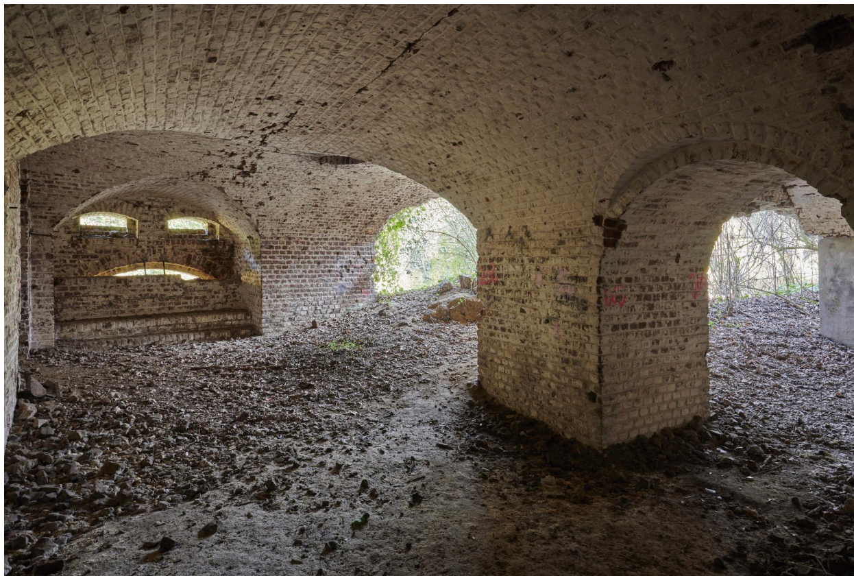
Aile est. Caponnière double. Embrasures de tir dans le mur de la galerie de flanquement, en partie effondrée.
