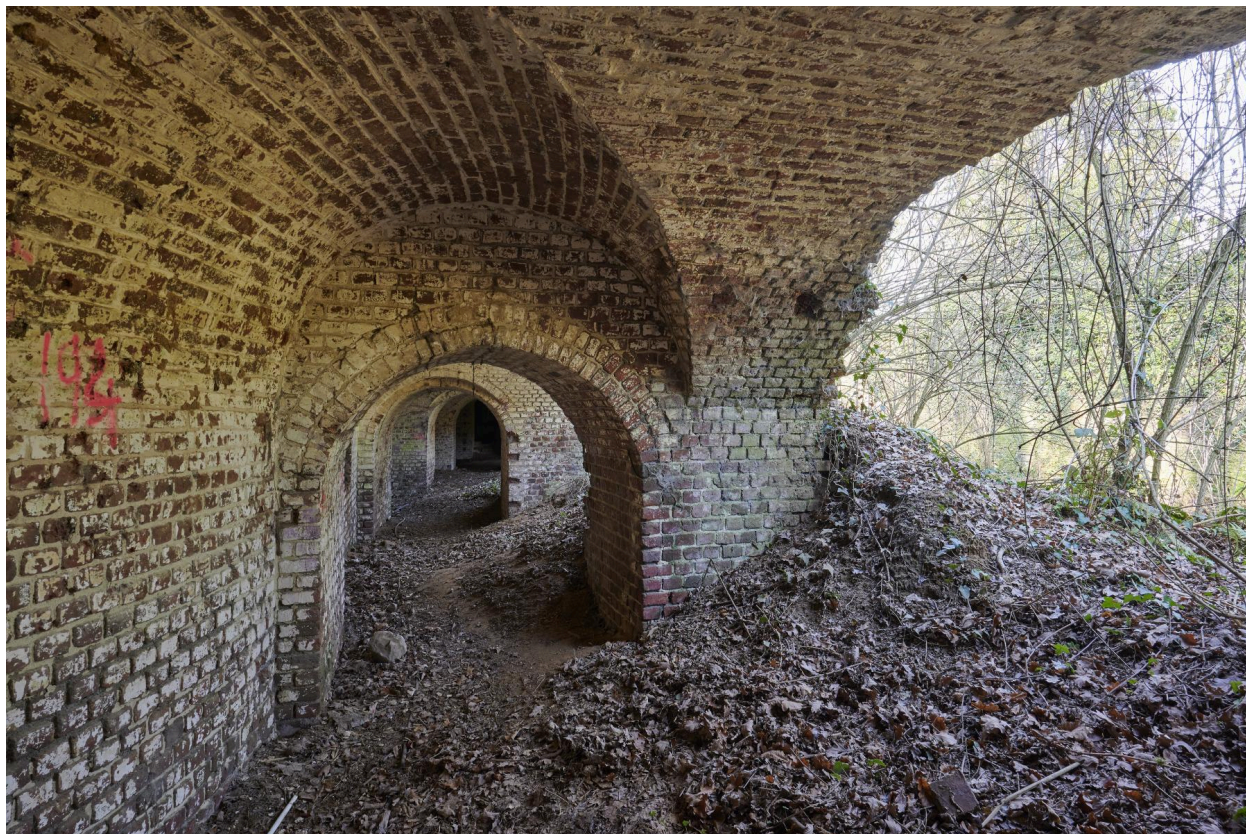
Aile est. Partie effondrée des galeries flanquantes.
