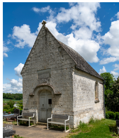
Chapelle du cimetière, vue prise depuis le sud-ouest. Phot. Marc Kérignard IVR32_20246000401NUCA
