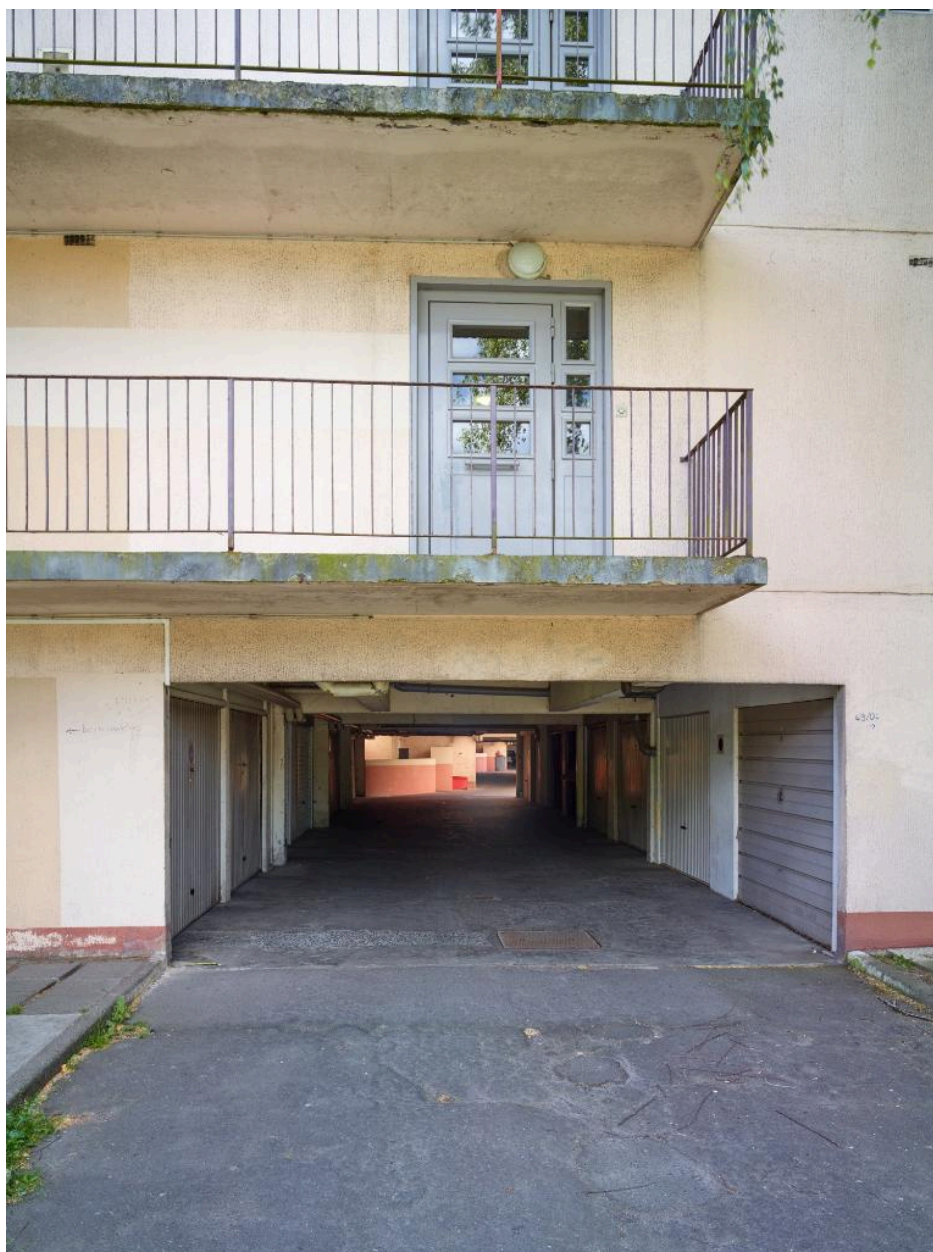
Entrée du garage collectif, en tunnel sous l'immeuble (n° 45), et desserte des étages.
