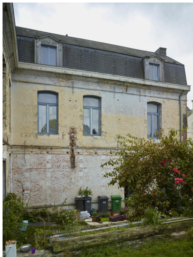
Ancienne école privée : façade arrière de l'aile principale. Phot. Pierre Thibaut IVR32_20245900377NUCA
