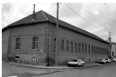
Élévation antérieure (flanc nord) des ateliers de fabrication. Phot. Benoît Dufournier IVR22_19888001110Z
