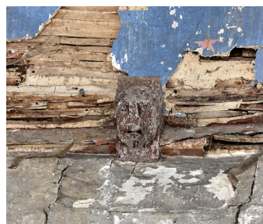
Blochet sculpté du chœur, à tête de personnage. Phot. Thierry Lefébure IVR32_20238000314NUCA
