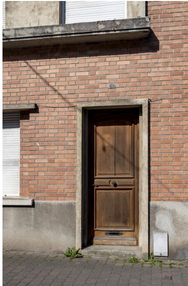
Détail du décor en fer forgé protégeant la porte du n°15 : porte modifiée. Remplacée par une porte en bois peint, elle a perdu son décor en fer forgé. Phot. Pierre Thibaut IVR32_20255900507NUCA
