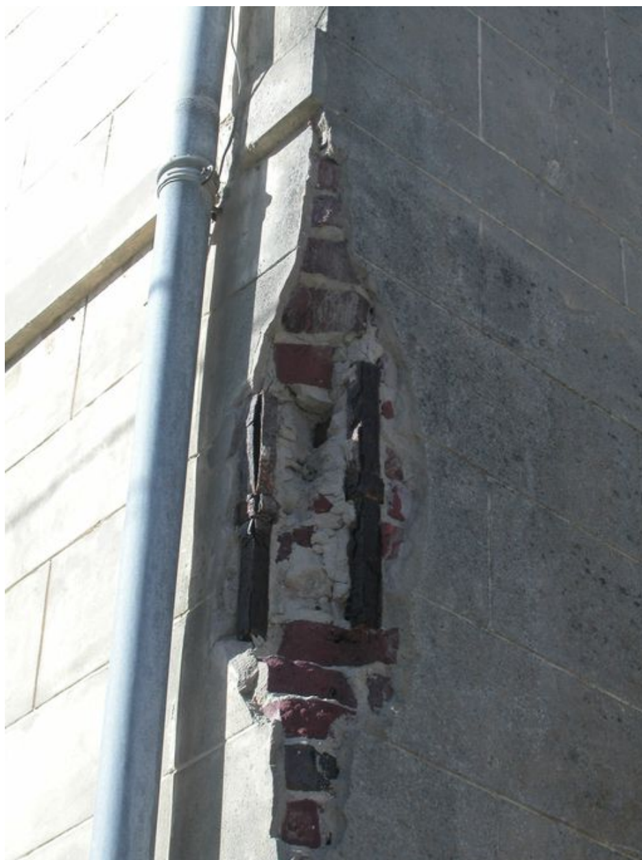
Détail d'une chaîne d'angle dégradée.
