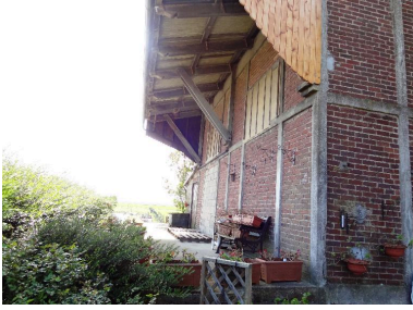
Vue actuelle de l'ancien quai et de l'ancien hangar de la gare de Saint- Quentin-la-Motte-Croix-au-Bailly. Phot. Frédéric-Nicolas Kocourek IVR22_20148005013NUC2A
