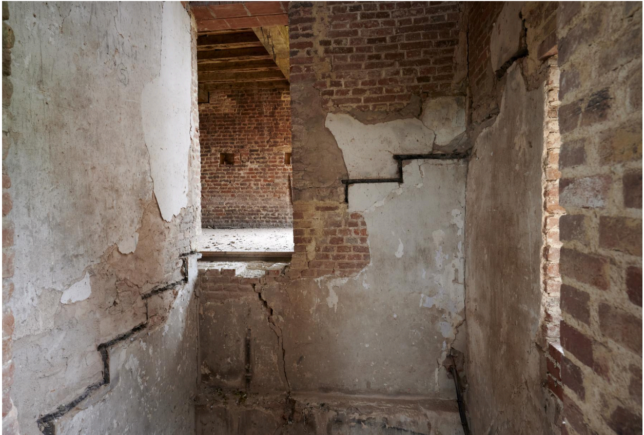
Premier étage. Logis du XVI e siècle. Ancienne cage d'escalier desservant les étages et la tour porche.
