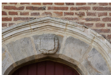
Détail de la porte d'accès principale au logis du XVIIe siècle. Blason. Phot. Pierre Thibaut IVR32_20236200153NUCA
