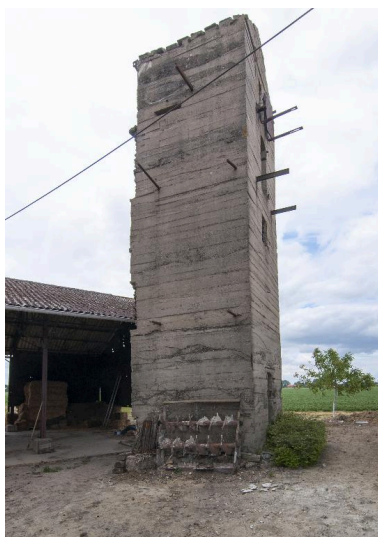
Vue de trois-quarts vers le nord-est de l'observatoire casematé (A). On note la présence d'une embrasure au sommet, orientée vers l'ouest Phot. Jean-Marc Ramette IVR32_20165901023NUCA
