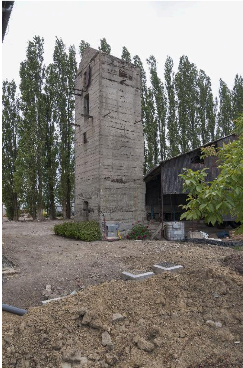
Vue de trois-quarts vers l'ouest de l'observatoire casematé (A). On note la présence de trois portes et d'une baie dotée d'une grille
