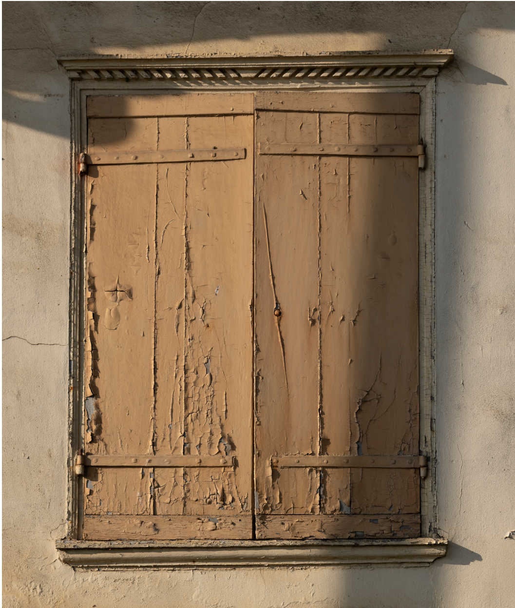
Détail d'une baie et de son cadre avec modénatures, n°4 de la place de Beauvoir.
