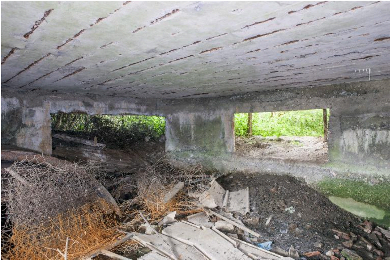
Vue intérieure de la chambre de tir, vers le nord : les deux embrasures de tir.
