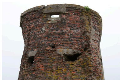
Vue de détail des parties hautes du poste d'observation. Phot. Pierre Thibaut IVR31_20126201770NUCA
