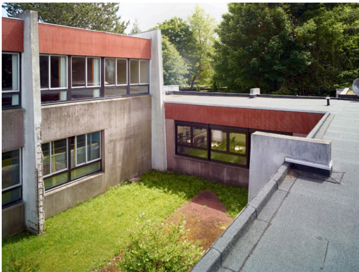
Terminaison du patio central vers le sud ouest, depuis la toiture du C.E.T.
