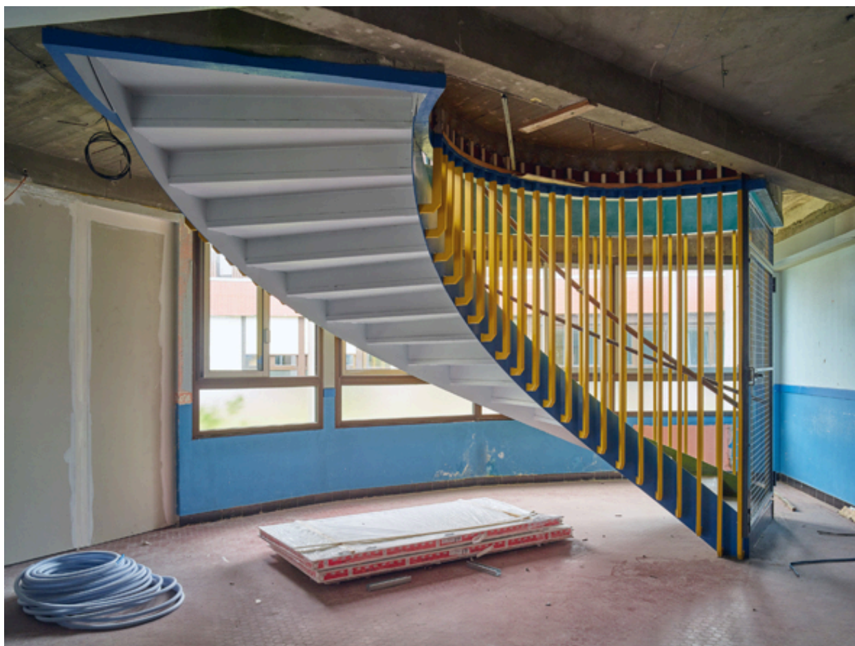
Vue de la sous-face et de la courbe de l'escalier situé dans le C.E.S., reliant le préau couvert du rez-de-chaussée, au hall de détente au premier étage.
