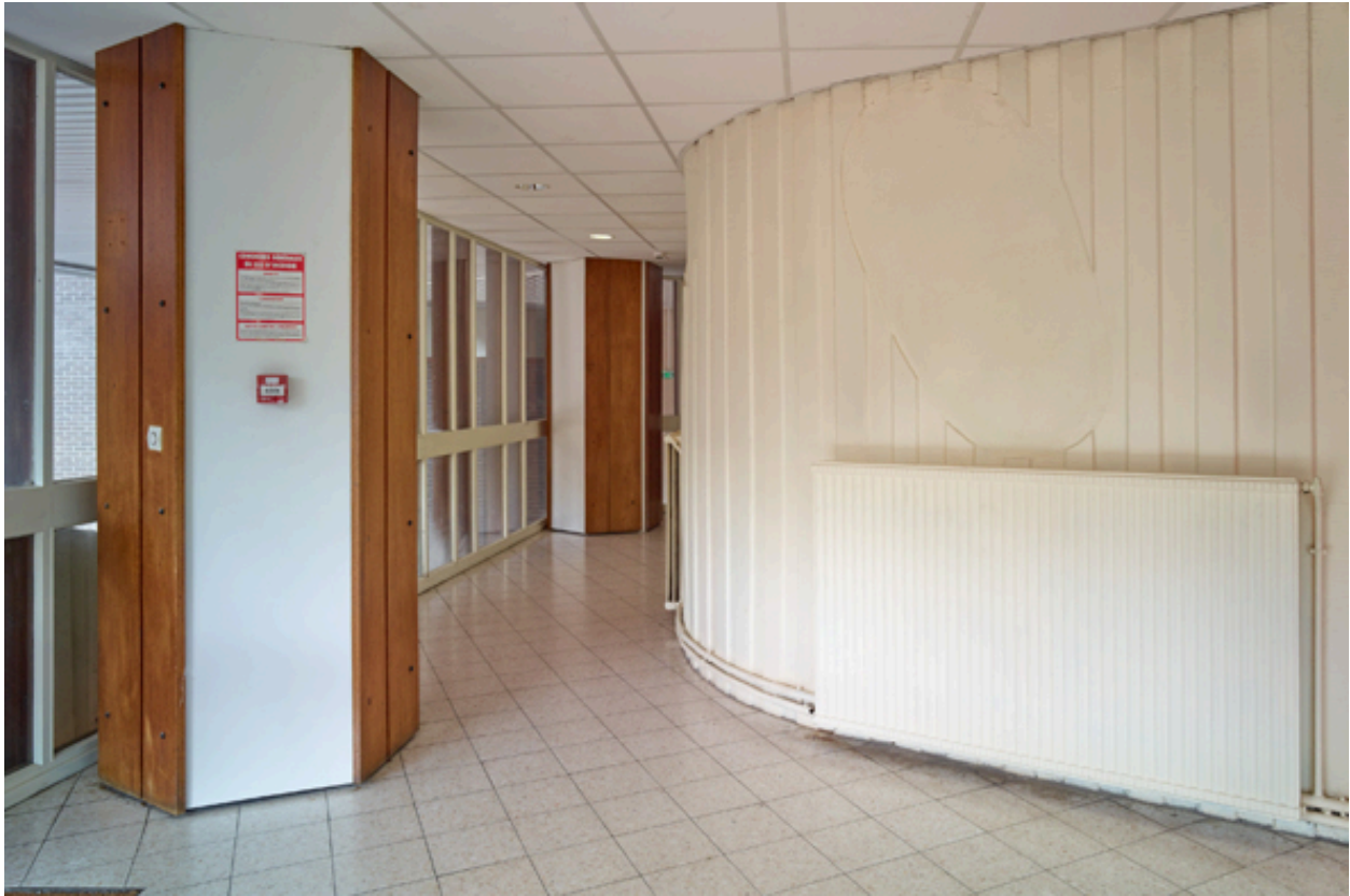
Vue des poteaux de forme hexagonale et du noyau central contenant les circulations de la tour de l'internat, depuis le niveau de la plate-forme.
