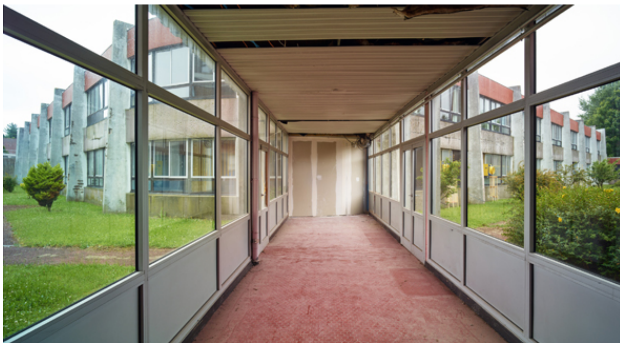
Vue de la liaison entre le C.E.T. et le C.E.S. depuis l'intérieur du couloir, à l'intersection du patio central.
