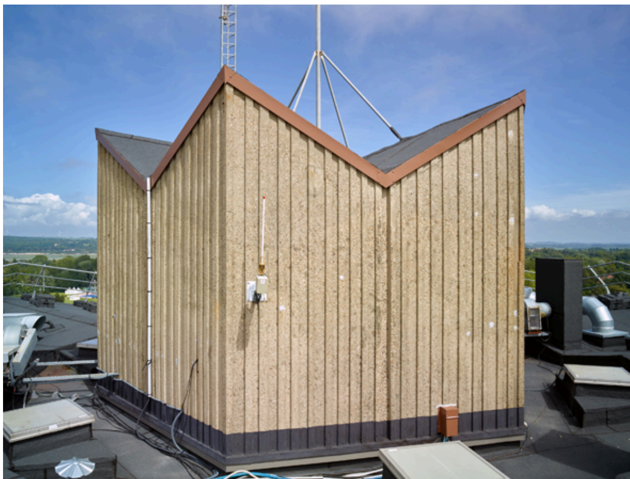
Vue du local à machine de l'ascenseur sur la toiture de la tour de l'internat.
