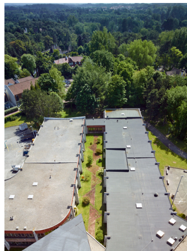
Vue générale du patio central sud ouest depuis la toiture de la tour de l'internat.
