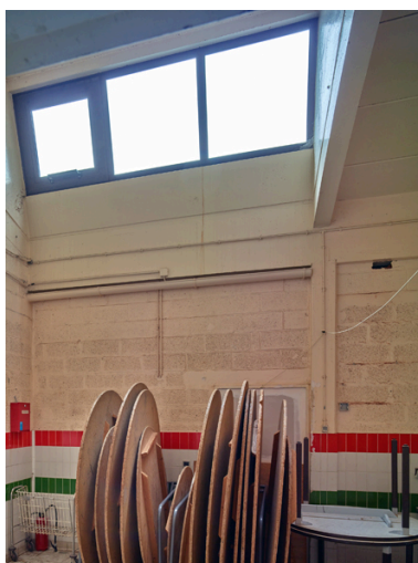
Vue des ouvertures dans la toiture à redents des anciennes cuisines pédagogiques.
