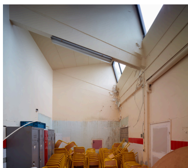
Vue de la toiture à redans depuis l'intérieur des anciennes cuisines pédagogiques.
