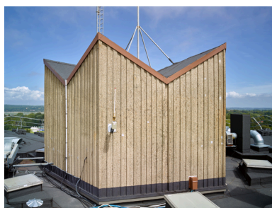
Vue du local à machine de l'ascenseur sur la toiture de la tour de l'internat. Phot. Pierre Thibaut IVR32_20176200094NUCA
