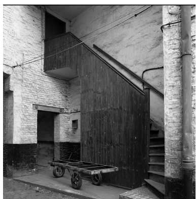
Escalier menant au logement patronal (cf. angle de prise de vue 3). Phot. Philippe Dapvril IVR31_19885900773X
