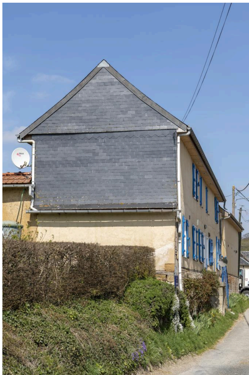
Pignon essenté en ardoise, détail du logis n°3 rue du Chauffour, vue depuis le sud.
