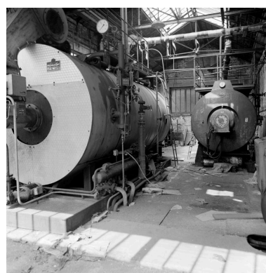
Chaudière, vue intérieure. Chaudières. Phot. Philippe Dapvril IVR31_19885901248X
