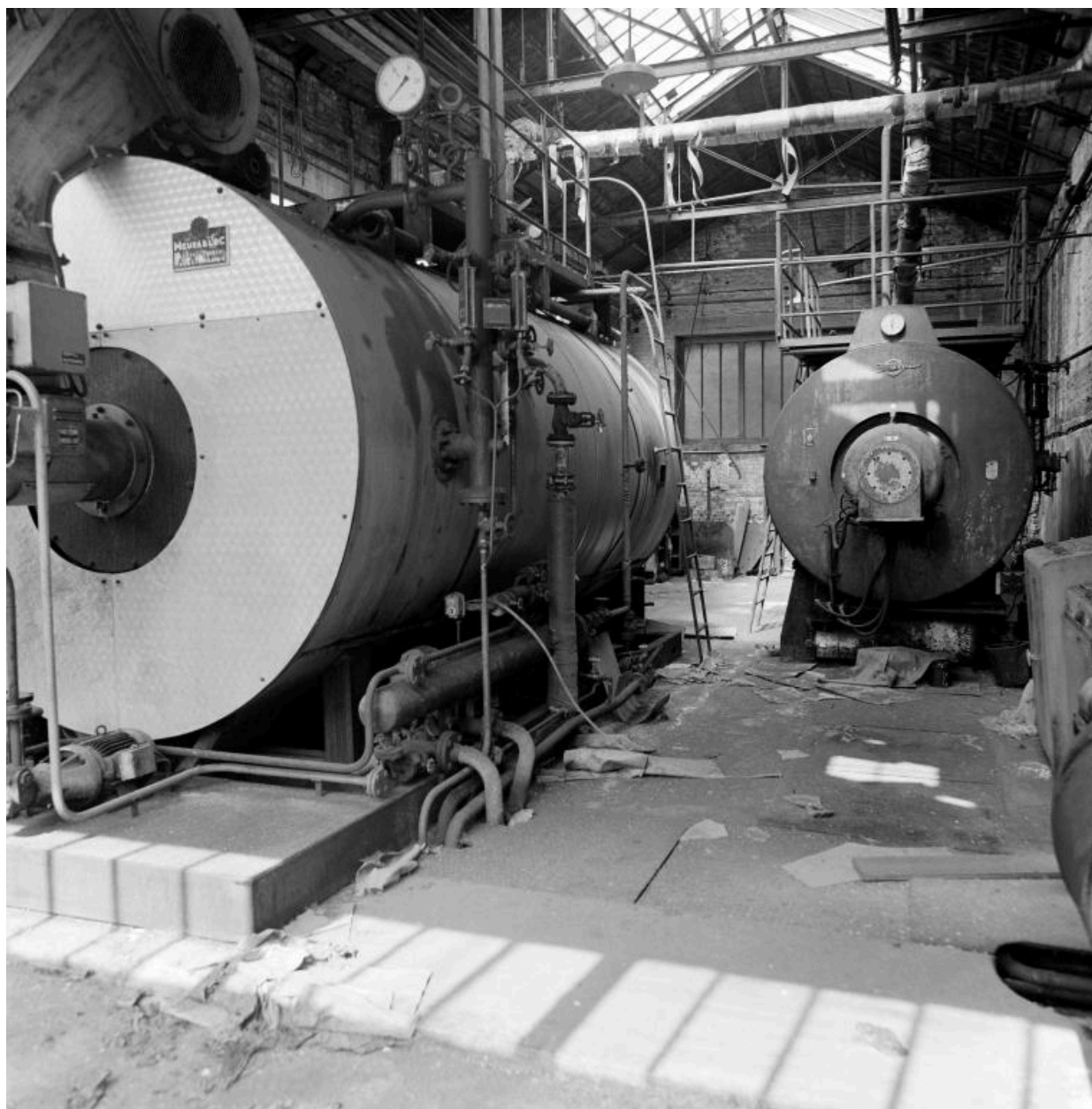
Chaufferie, vue intérieure. Chaudières.
