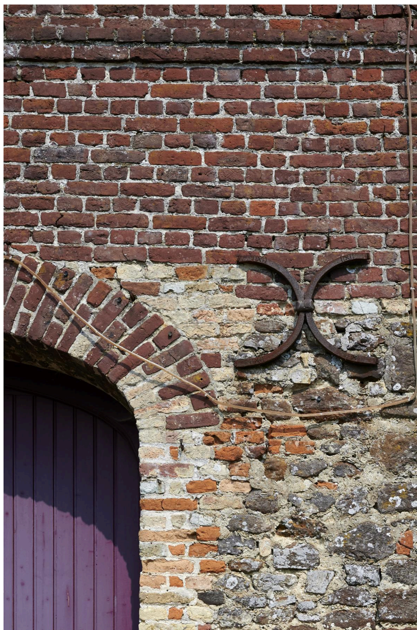
Détail d'un fer d'ancrage en "X" de l'église. Matériaux : brique et grès de Cassel.
