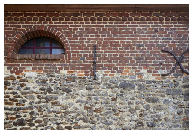
Bas-côté nord de l'avant porche de l'église. Fer d'ancrage en ancre droite, soubassement en grès de Cassel, briques. Phot. Delphine Volto Jourdan IVR32_20235900664NUCA
