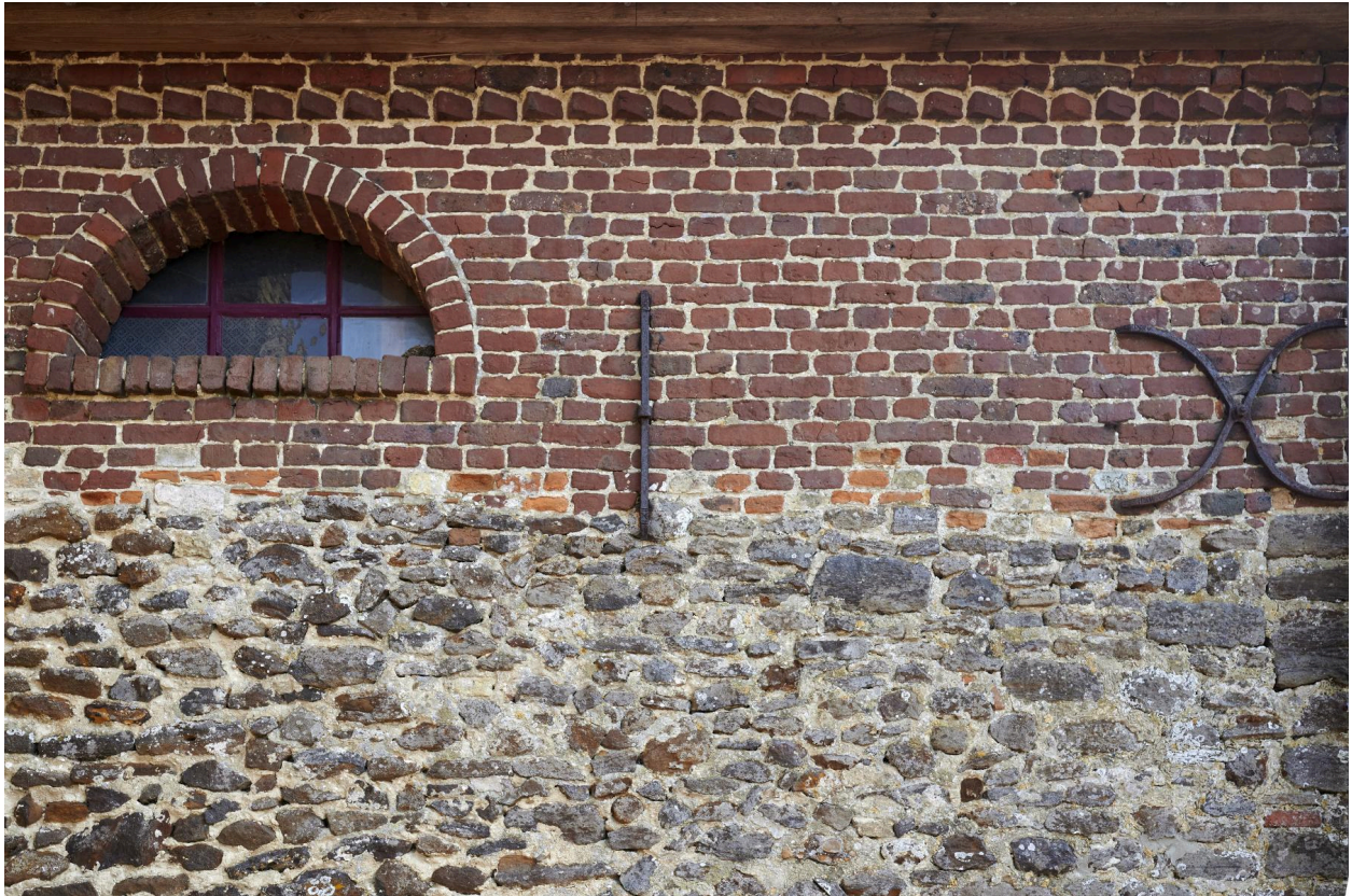
Bas-côté nord de l'avant porche de l'église. Fer d'ancrage en ancre droite, soubassement en grès de Cassel, briques.
