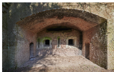
Embrasures de tir de la caponnière double battant le fossé de tête. Phot. Pierre Thibaut IVR32_20235900284NUCA
