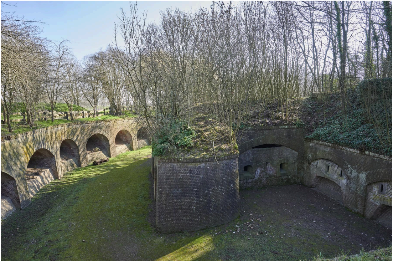
L'orillon de la caponnière double en plongée depuis la contrescarpe, vers l'est. À droite, les créneaux de fusillade ; à gauche, les arcs de décharge de la contrescarpe.
