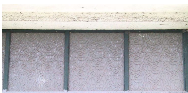
Solarium, détail de la vitrerie d'origine, état en 2005. Phot. Olivier Liardet IVR31_20065906152NUCA
