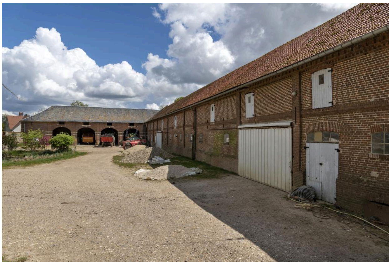
Anciennes étable et bergerie, surmontées d'un fenil, puis remises agricoles en retour, vue depuis l'ouest.
