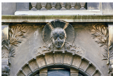
Façade sur voie, détail : haut-relief représentant une tête de boulonnaise. Phot. Philippe Caudroit IVR31_19826200215ZA
