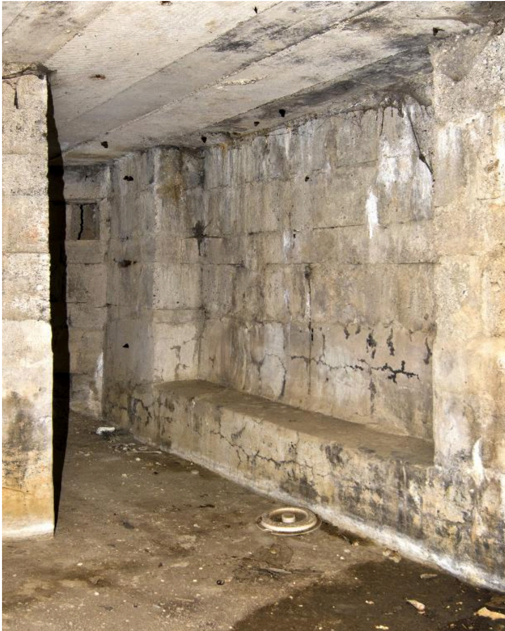
Vue intérieure. Passage entre les deux salles et grande niche, à droite
