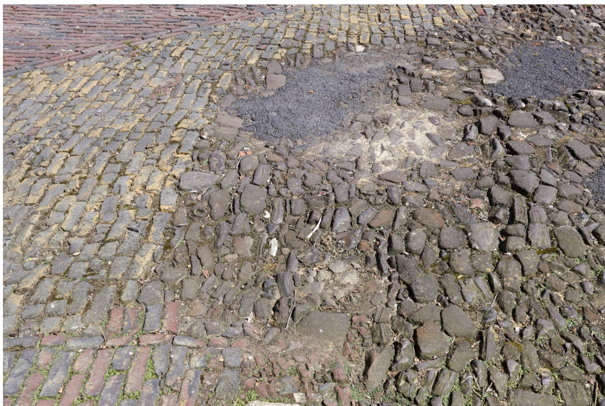
Détail du pavage hétérogène de la cour avec grès de Cassel, briques jaunes et rouges.
