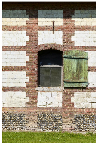
Magasin à fourrage, détail de l'appareil de construction autour d'une des ouvertures de la façade sur cour. Phot. Thierry Lefébure IVR32_20258001202NUCA
