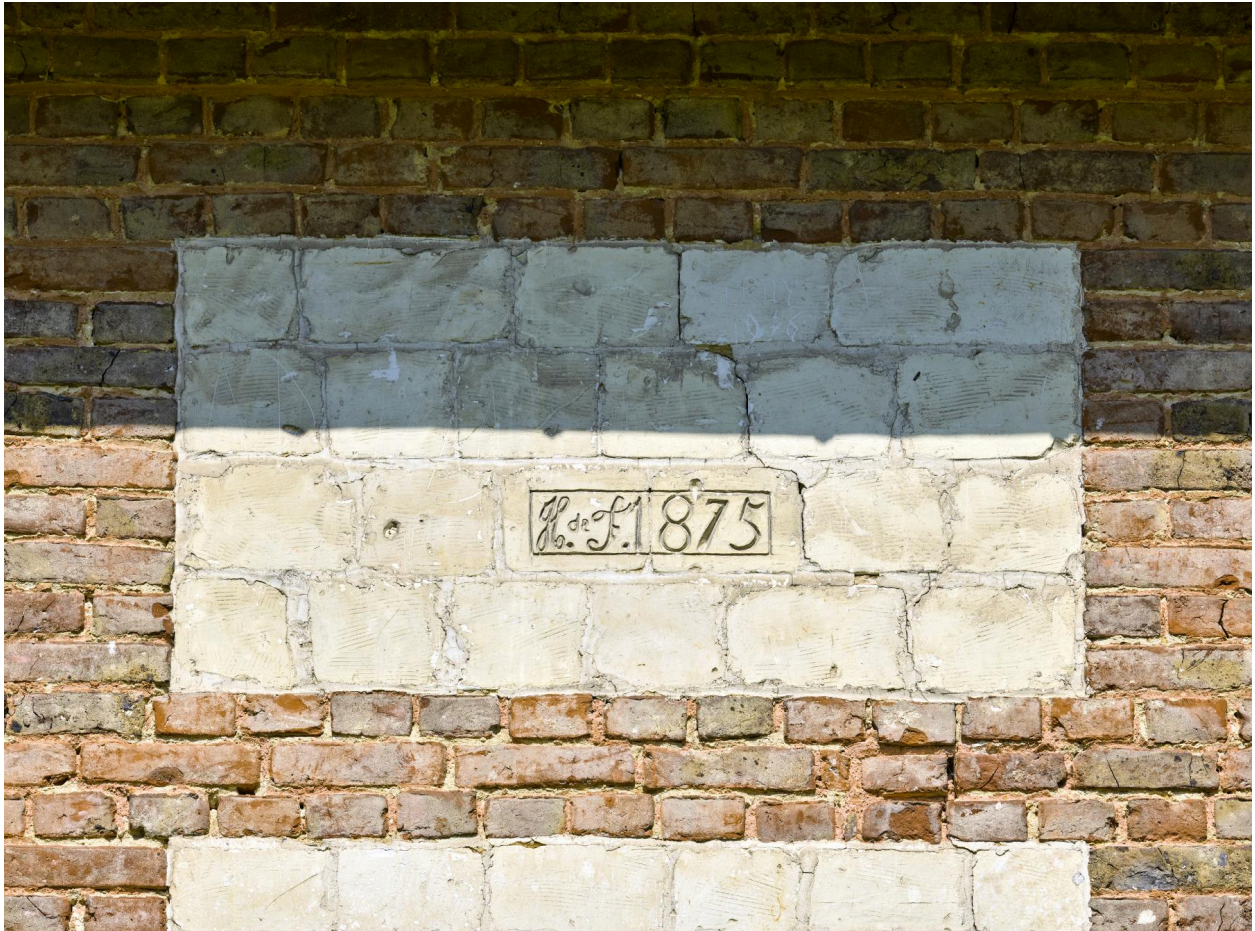
Magasin à fourrage, détail des initiales et de la date de 1875 situées au-dessus de l'entrée.
