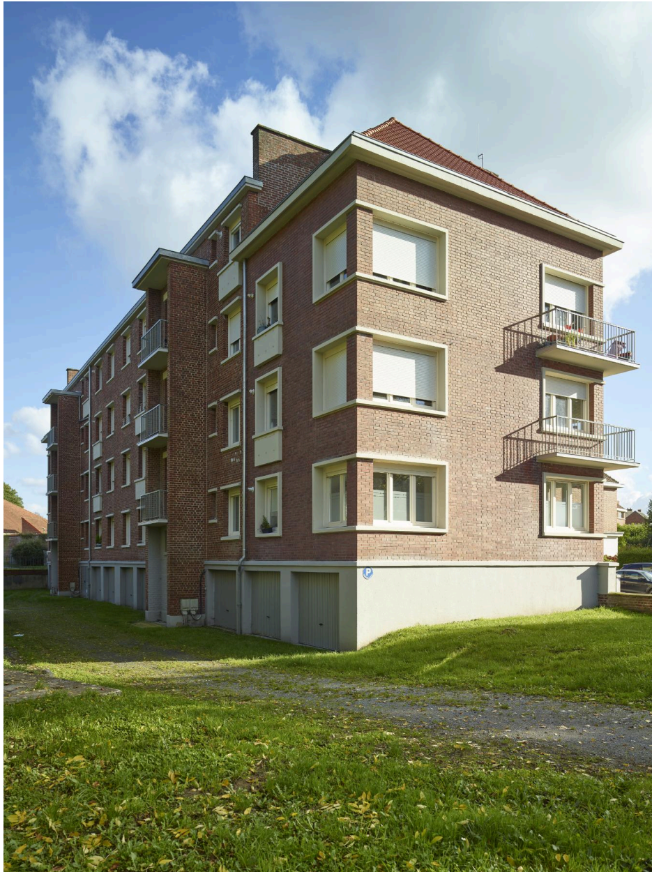
Vue sur le mur-pignon ouest et la façade arrière. Vue orientée ouest/est.
