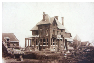
La maison de l'ingénieur agronome en cours de construction, mai 1921 (AD Somme ; 49 Fi 65). Phot. Fournier Bertrand (reproduction) IVR22_20158006159NUCA
