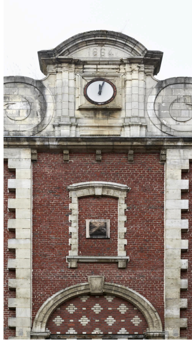
Façade ancienne, pignon à volutes avec fronton semi-circulaire au centre, tympan décoratif de la porte centrale, détail. Phot. Delphine Volto Jourdan IVR32_20265900099NUCA
