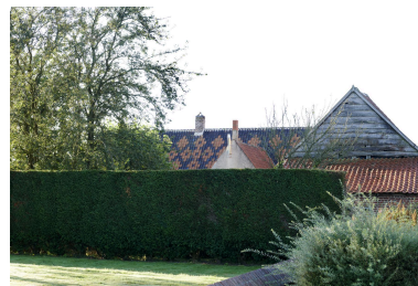
Détail de la couverture en pannes flamandes sur le versant nord de la toiture. Phot. Delphine Volto Jourdan IVR32_20245903085NUCA
