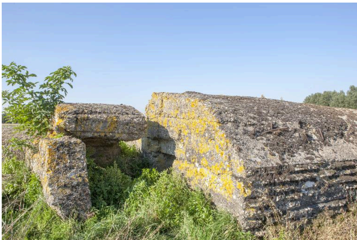
Dispositif pare-souffle de l'entrée ouest
