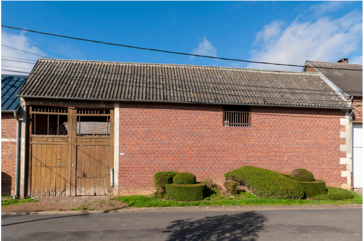
Grange reconstruite en brique, n°19 rue de la Mairie, vue depuis le sud-est.
