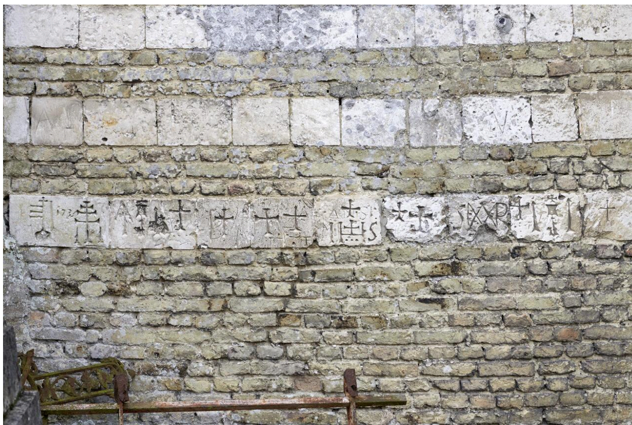
Graffitis dévotionnels XVIIIe siècle sur le mur extérieur du chevet de l'église.
