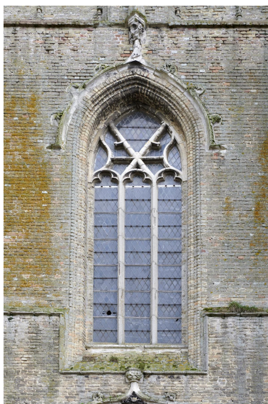
Baie du bas-côté nord. Gothique flamboyant tardif. Phot. Delphine Volto Jourdan IVR32_20255900462NUCA
