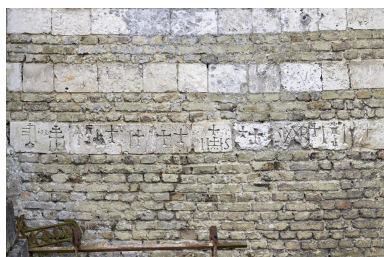
Graffitis dévotionnels XVIIIe siècle sur le mur extérieur du chevet de l'église. Phot. Delphine Volto Jourdan IVR32_20255900446NUCA
