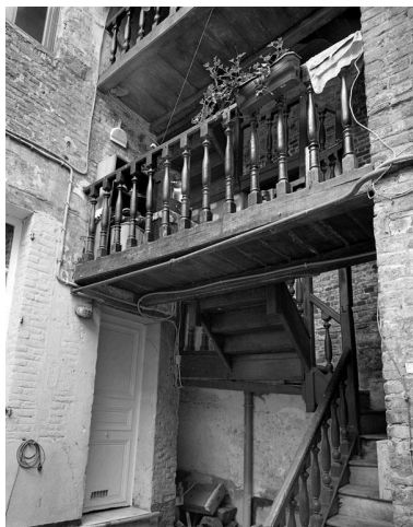
Vue de l'escalier de la cour arrière, qui relie le bâtiment principal au second logis. Phot. Thierry Lefébure IVR22_20020200824V
