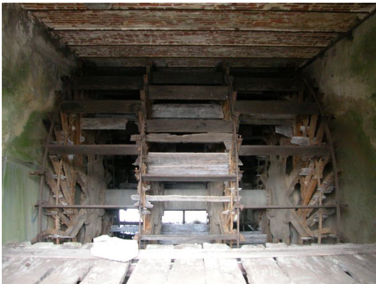
La roue hydraulique, vue de face.
