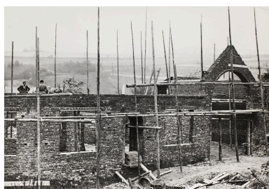
Reconstruction de la maison d'habitation et de la porte charretière de la ferme Becquer, par Jean Hubert photographe à Amiens, 19 avril 1951 (AD Somme ; 1272 W 515).
