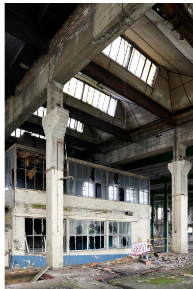
Cabine de commande installée dans l'ancienne salle des machines. Phot. Delphine Volto Jourdan IVR32_20215900418NUCA
