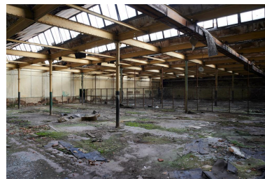
Intérieur de la filature. Vue générale du troisième étage. Phot. Delphine Volto Jourdan IVR32_20215900404NUCA
