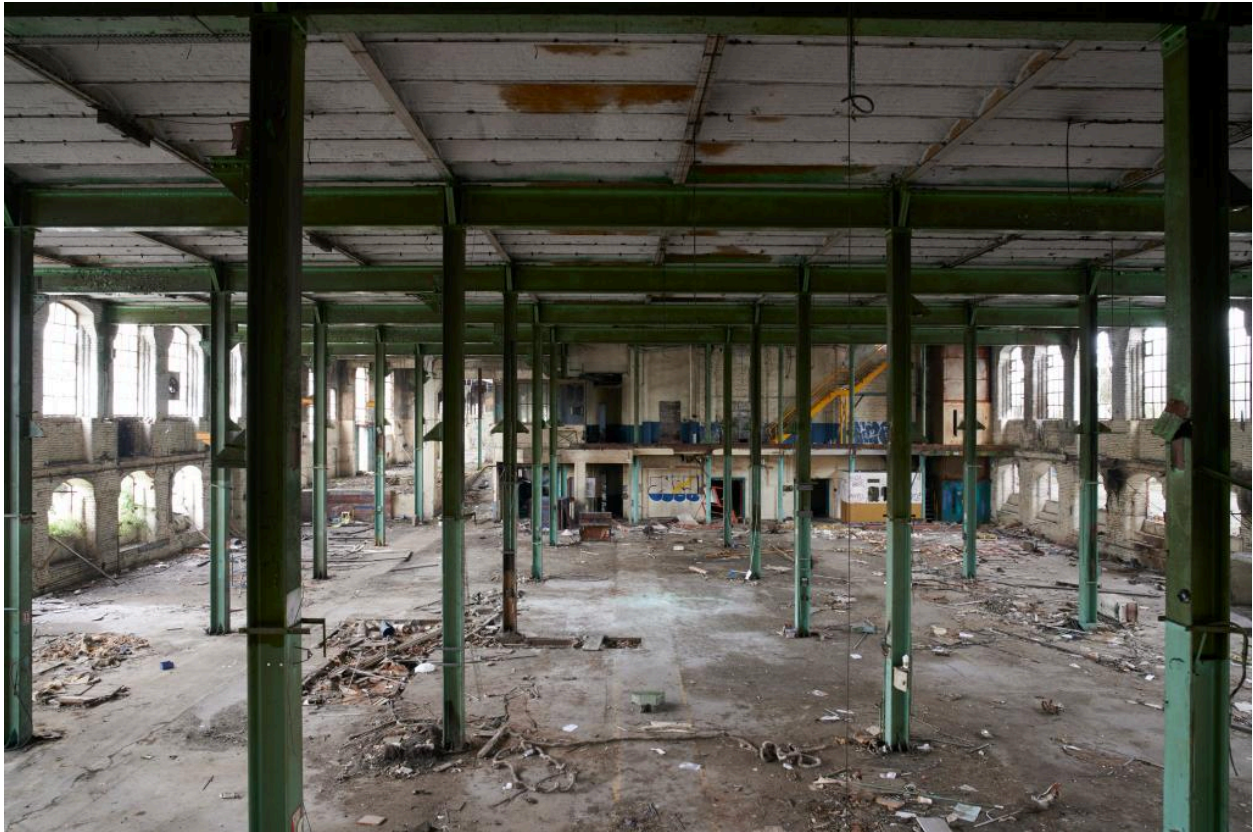
Vue intérieure de la filature (le plancher du rez-de-chaussée surélevé a été supprimé).
