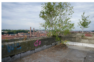
Terrasse couvrant la tour maçonnée hors-oeuvre distribuant les différents niveaux de la filature. Phot. Delphine Volto Jourdan IVR32_20215900407NUCA
