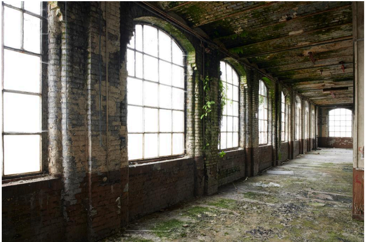
Vue intérieure de la filature. Vue longitudinale du deuxième étage. Détail des baies.
