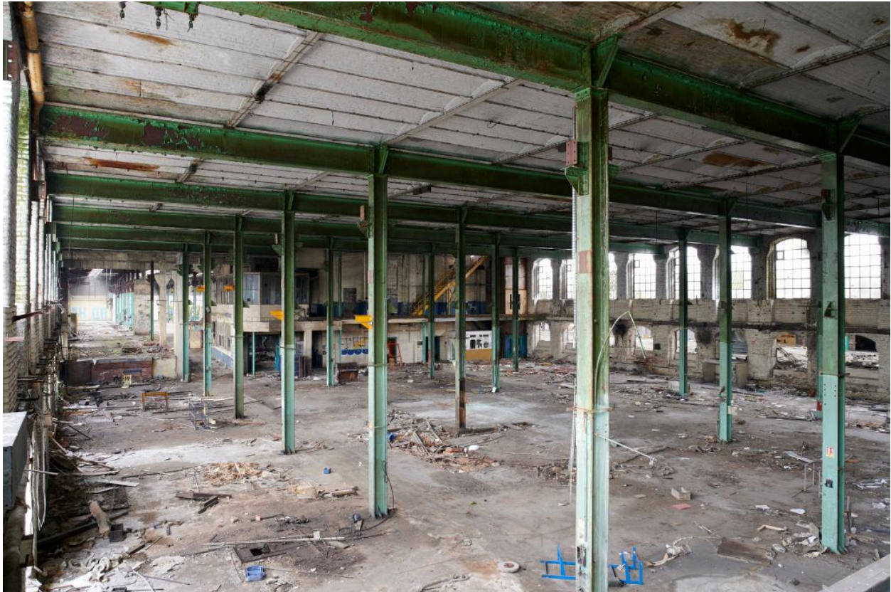
Vue intérieure de la filature (le plancher du rez-de-chaussée surélevé a été supprimé).
