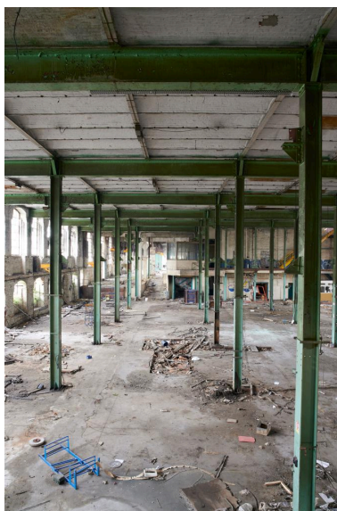
Vue intérieure de la filature (le plancher du rez-de-chaussée surélevé a été supprimé). Phot. Delphine Volto Jourdan IVR32_20215900391NUCA
