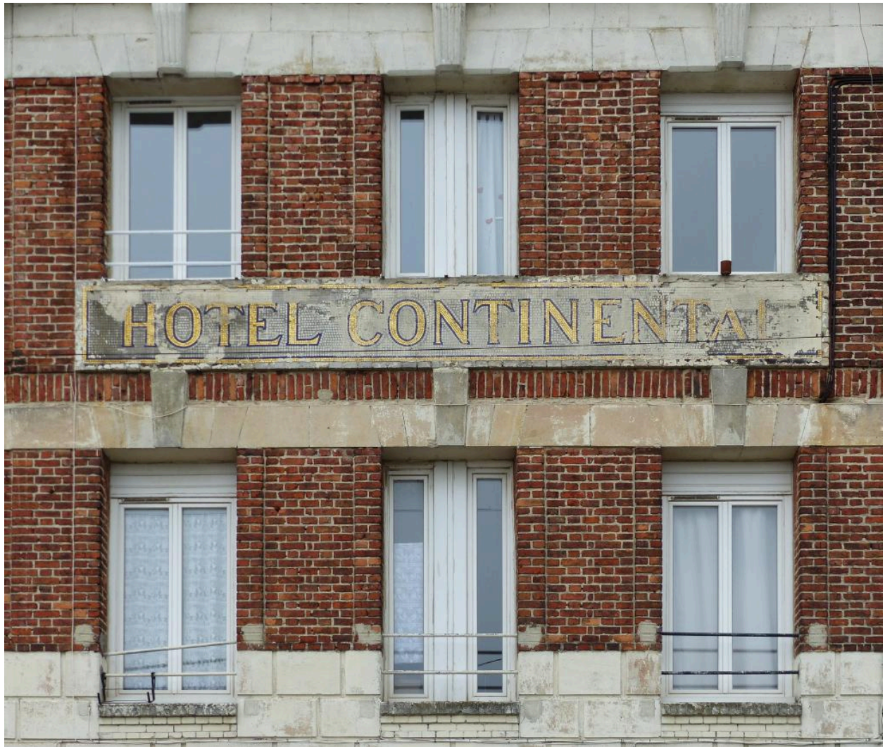
Vue de détail de la façade sur rue et du cartouche portant l'inscription HOTEL CONTINENTAL.
