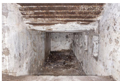
Vue générale, depuis le premier niveau de l'édifice vers le niveau intermédiaire Phot. Pierre Thibaut IVR32_20165900019NUCA
