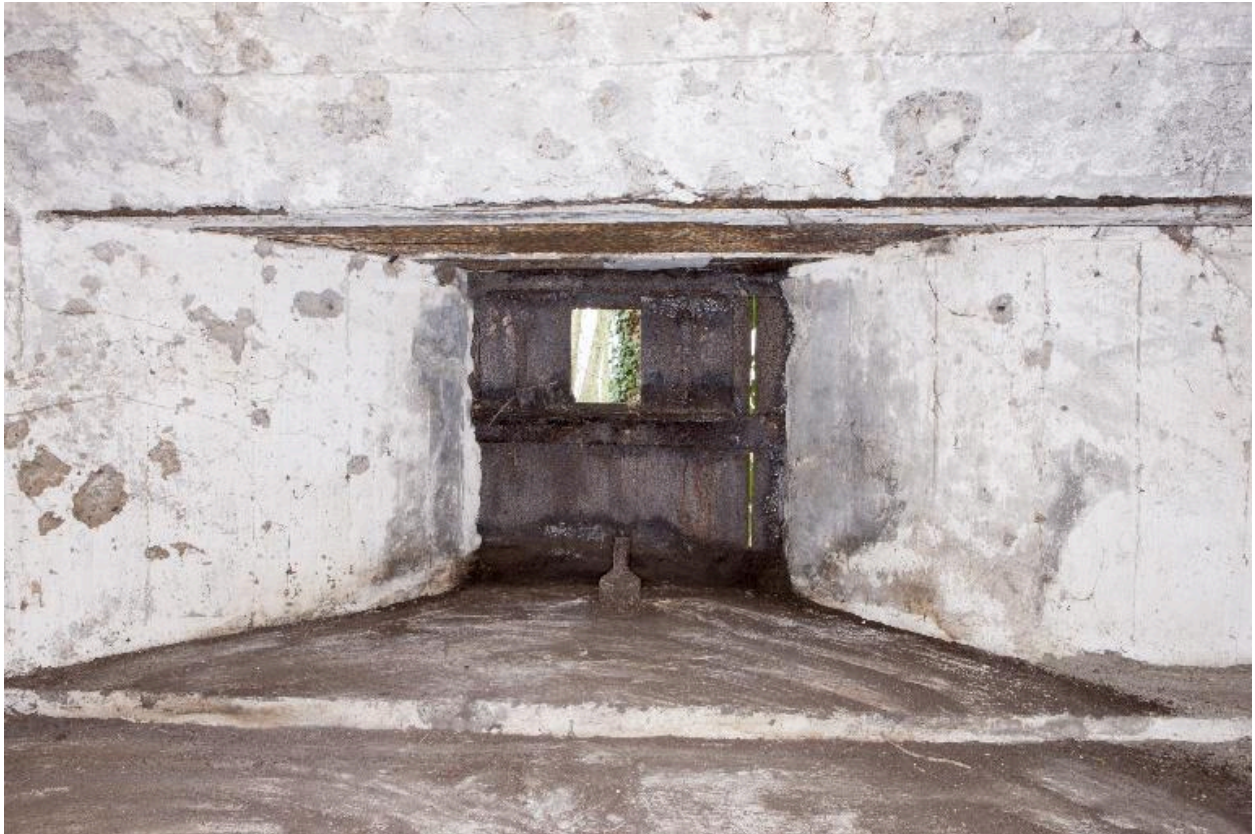
Détail du créneau de fusillage depuis la table de la mitrailleuse au premier niveau de l'édifice
