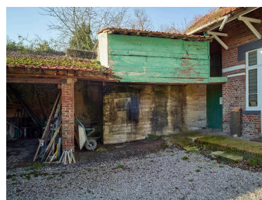
Partie nord de la casemate, depuis la cour de la ferme. Phot. Pierre Thibaut IVR32_20185900092NUCA
