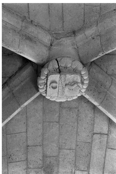
Clef de voûte de la chapelle ouvrant au nord de la nef, ornée des armoiries de la famille Marquet de Montbreton. Phot. Thierry Lefébure IVR22_19900200496X
