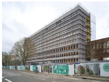
Le bâtiment provisoire dit R8 en cours de démolition, depuis la rue du Ballon.
