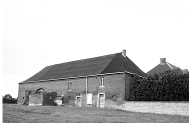
Vue externe du bâtiment ouest à usage de logement et étable. Phot. Thierry Lefébure IVR22_19960200587X
