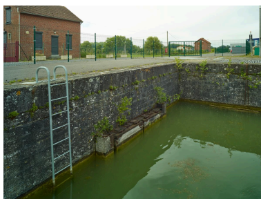
Le bassin de tranquillisation avec échelle de secours. Au second plan la maison de service (amont).
