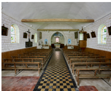
Intérieur, vue de la nef depuis le portail occidental. Phot. Thierry Lefébure IVR32_20248001204NUCA
