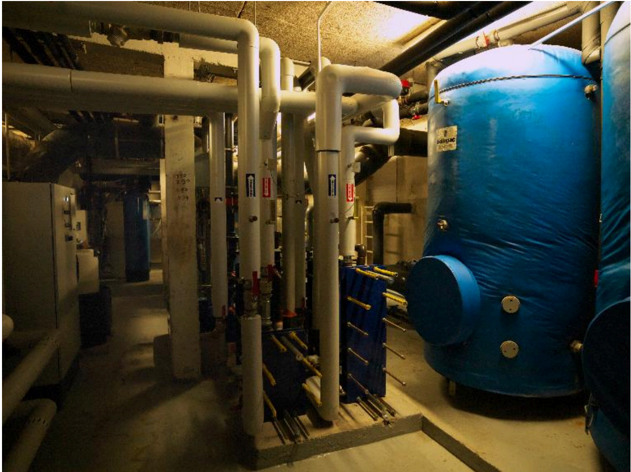
Vue générale de la machinerie en sous-sol ; à droite les ballons d'eau chaude.
