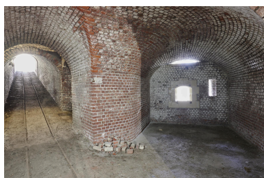
Descente de la caponnière double et chambre de tir. Phot. Pierre Thibaut IVR32_20235900096NUCA
