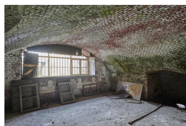
Sous-sol de caserne de gorge. Caserne de flanquement est. Phot. Pierre Thibaut IVR32_20235900068NUCA
