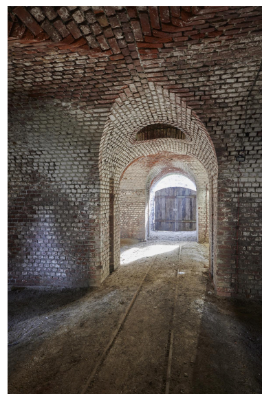
Sortie de descente de la caponnière double ouvrant sur le fossé de tête. Cheminée d'évacuation des fumées d'artillerie.
