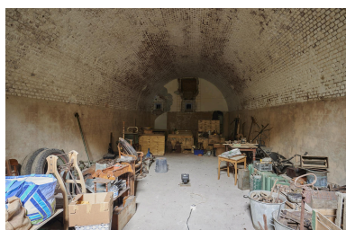
Vue intérieure du magasin à poudre est avec ouvertures du bas pour la ventilation, médianes pour les lanternes, et baie du haut pour l'éclairage naturel.
