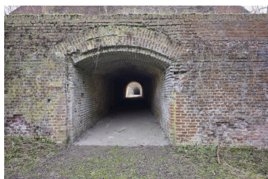
Entrée du couloir passant sous la partie est de crête d'artillerie, en direction de la caponnière double.
