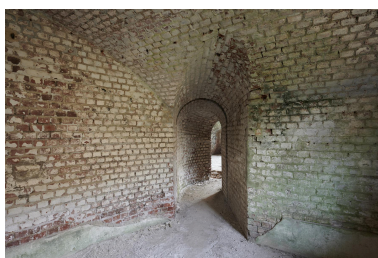
Sous-sol de caserne de gorge. Caserne de flanquement est. Couloir d'accès à la deuxième salle. Phot. Pierre Thibaut IVR32_20235900072NUCA
