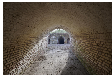
Couloir passant sous la partie est de la crête d'artillerie, en direction
