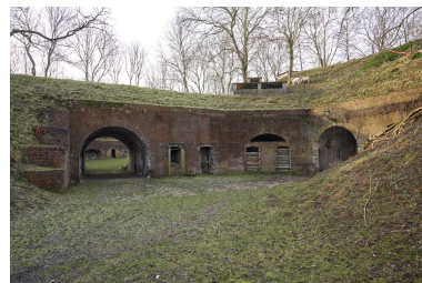
Cour est. À gauche, l'accès à la crête d'artillerie, à droite, passage menant à la cour centrale.
