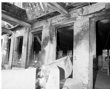
Atelier de fabrication après incendie, rez-de-chaussée. Phot. Olivier Marlard IVR31_19885902172X
