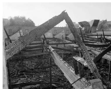
Atelier de fabrication après incendie, couverture. Phot. Olivier Marlard IVR31_19885902171X
