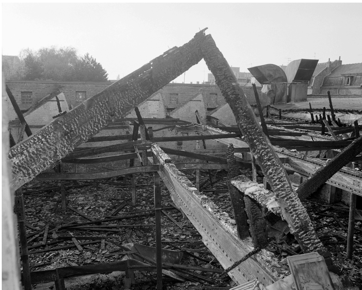
Atelier de fabrication après incendie, couverture.
