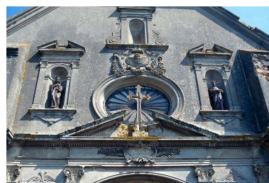
Détail de la partie supérieure du portail occidental. Phot. Martine Plouvier IVR22_19970200708ZA
